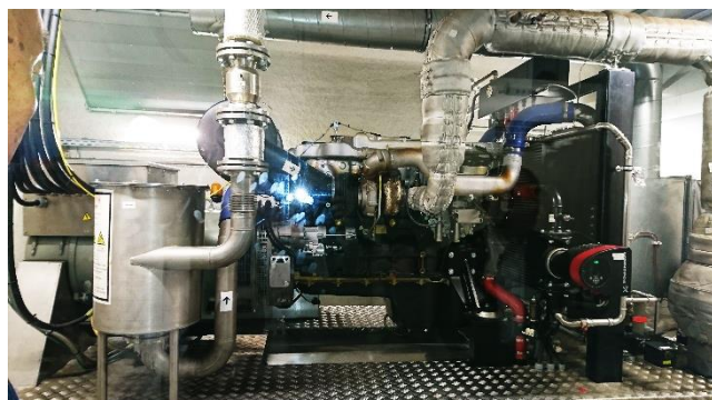
バイオマス発電施設内部のどでかいエンジン（ドイツ製）
